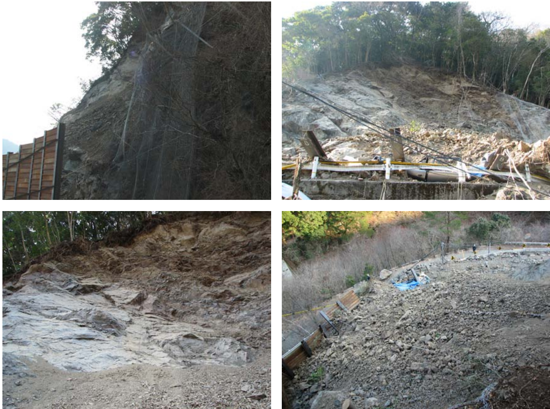
写真-2. 崩壊内部の写真. 左上：北から南を見上げる. 右上：崩壊を正面から見上げる（左半分に白く見える節理面が露出し，その上に褐色化した割れ目に富む岩盤が載る）. 左下：すべり面となった湾曲した節理面とその上の褐色化した岩盤. 右下：崩壊上部から堆積物を見下ろす.
